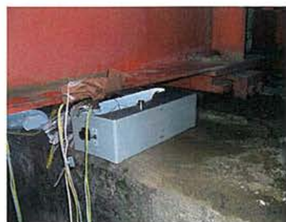
写真-3.1 高精度傾斜計 設置状況
