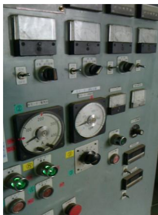
図 4.1 制御盤 (樹脂業界仕様)
