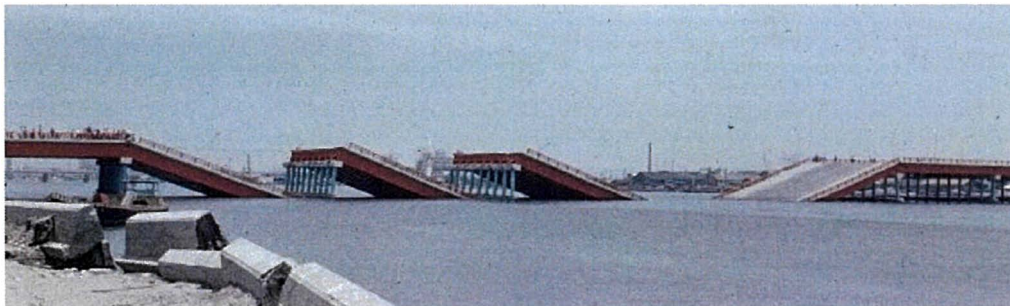
図-1.4 新潟地震による昭和大橋落橋
