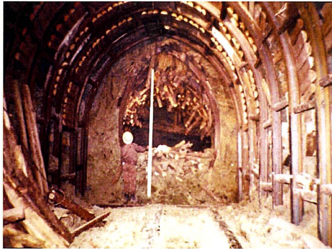
写真 2.3.1 中山トンネル変状状況 2.47)
