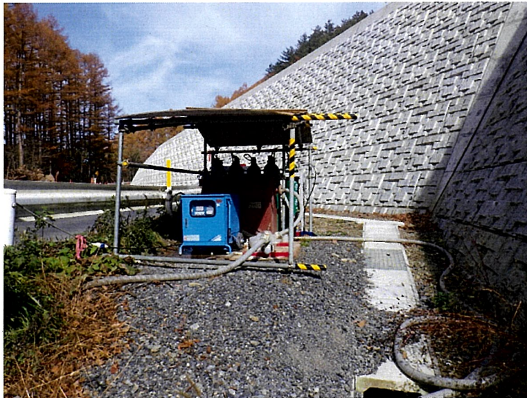
写真 3.2.2 中和処理設備
