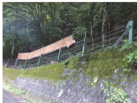
写真-1 従来型落石防護柵応急処置の例 (ベニヤ板で覆われている箇所が応急処置箇所)
