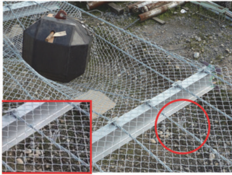
写真-5 ワイヤロープの素線切れ (CASE-1) Photo 5 Wire rope strands break (CASE-1)
