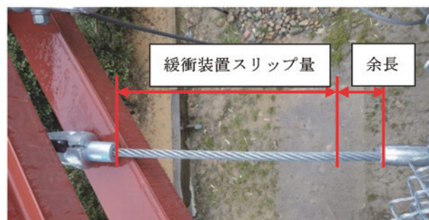
写真-12 緩衝装置のスリップ状況 Photo12 Slip condition of buffer device
