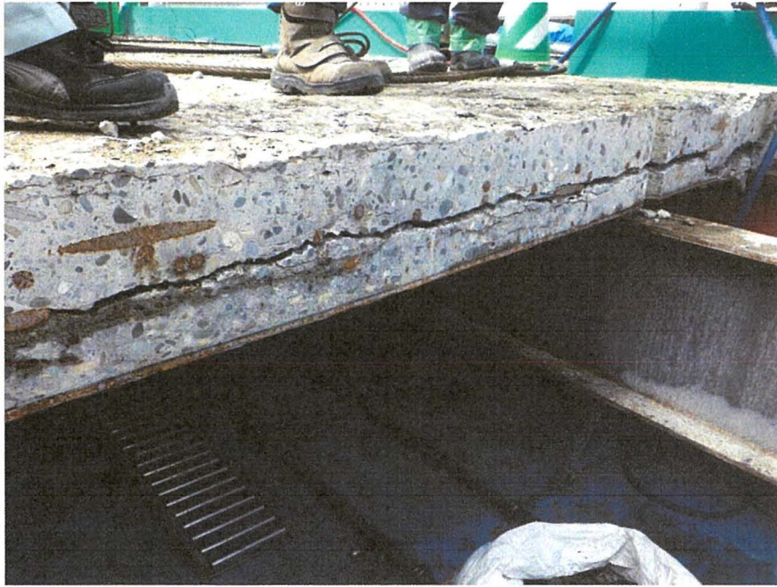
写真-2.3 取替前床版の水平ひびわれ状況
