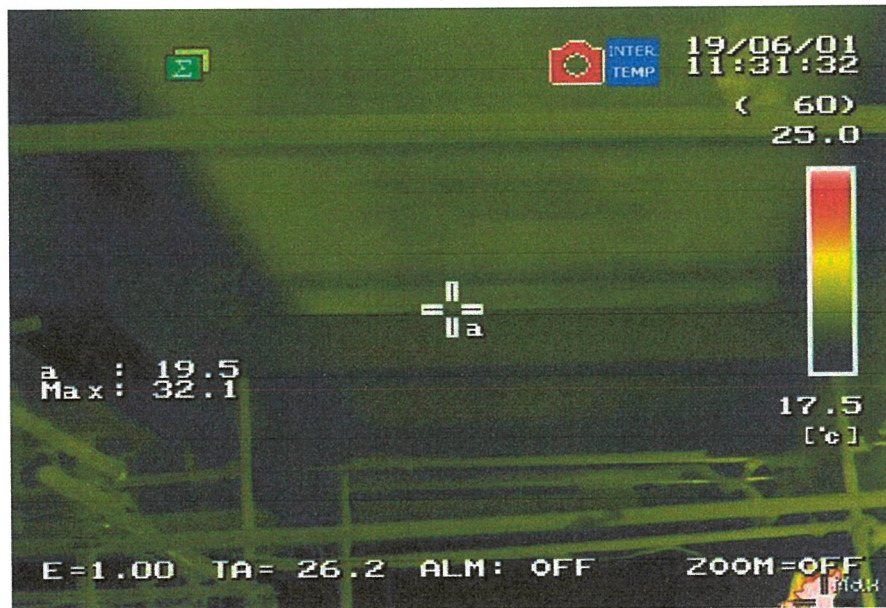
写真-3.2 赤外線サーモグラフィー画像（主桁，床版下面）
