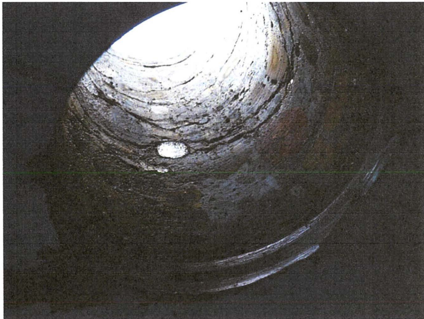
写真-2.4 取替前床版のコア採取孔における水平ひびわれ状況
