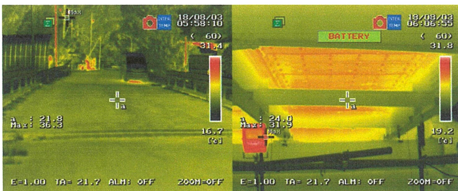
写真-付.18 床版取替前赤外線サーモグラフィ画像 (左：舗装表面，右：床版下面及び桁，2018年8月3日6:00)
