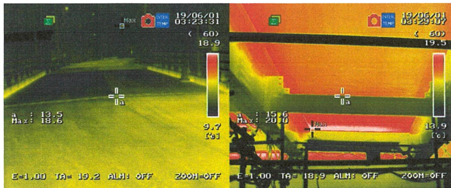
写真-付.34 床版取替後赤外線サーモグラフィー画像 (左：舗装表面，右：床版下面及び桁，2019年6月1日 3:30)
