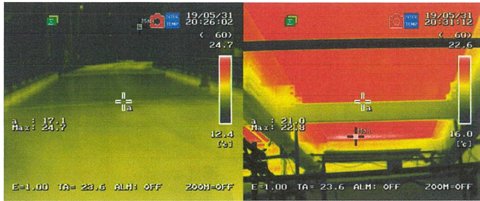
写真-付.28 床版取替後赤外線サーモグラフィー画像 (左：舗装表面，右：床版下面及び桁，2019年5月31日20:30)
