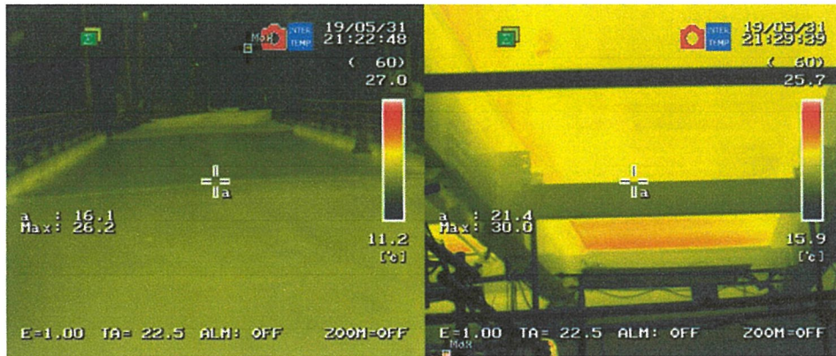
写真-付.29 床版取替後赤外線サーモグラフィー画像 (左：舗装表面，右：床版下面及び桁，2019年5月31日21:30)
