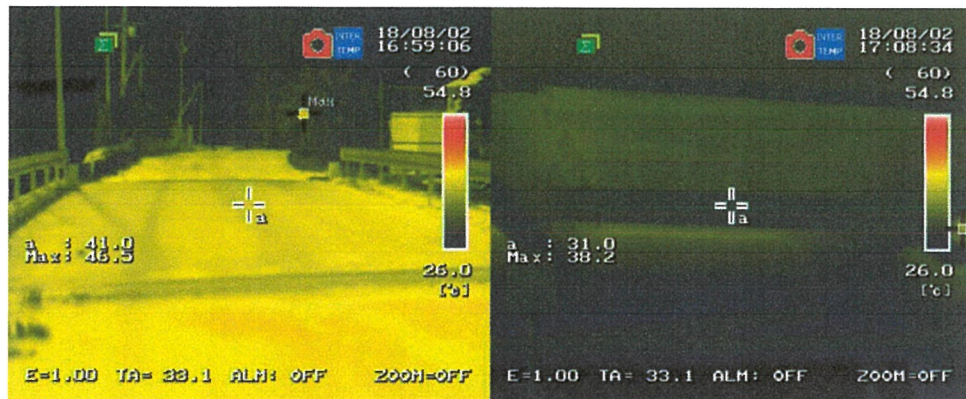
写真-付.7 床版取替前赤外線サーモグラフィー画像 (左：舗装表面，右：床版下面及びび桁，2018年8月2日17:00)
