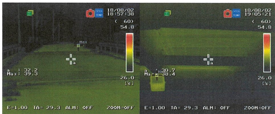
写真-付.8 床版取替前赤外線サーモグラフィー画像 (左：舗装表面，右：床版下面及びび桁，2018年8月2日19:00)
