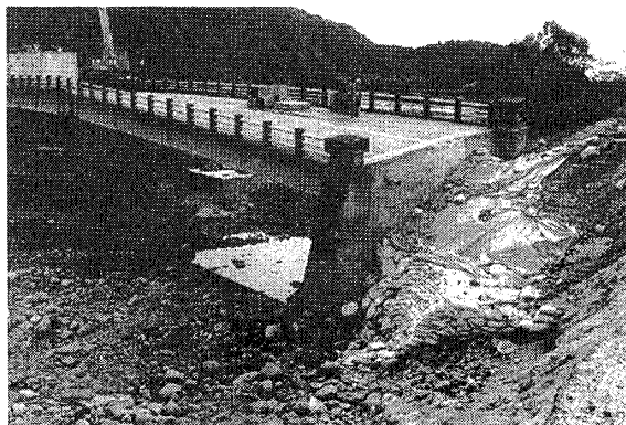
写真10 橋梁災害例 (1998.10 三輪撮影)
