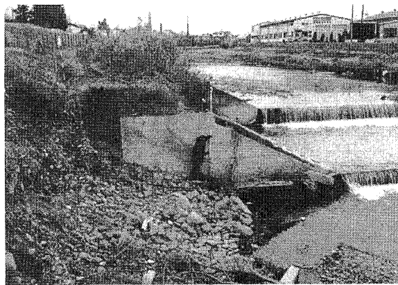
写真9 落差工取付け部の損壊例 (1998.10 三輪撮影)
