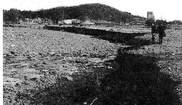
写真2 河岸侵食例(1998.12 三輪撮影)
