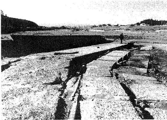
写真8 堤体の損壊例 (1998.10 三輪撮影)
