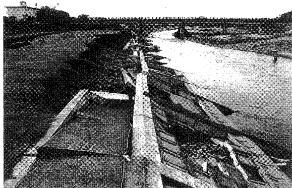
写真4 低水路護岸の侵食例 (1) (1998.10 三輪撮影)
