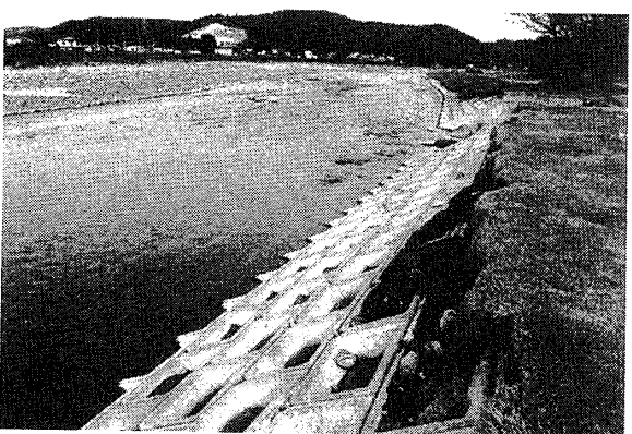
写真6 芝張り護岸の侵食例 (1998.10 三輪撮影)
