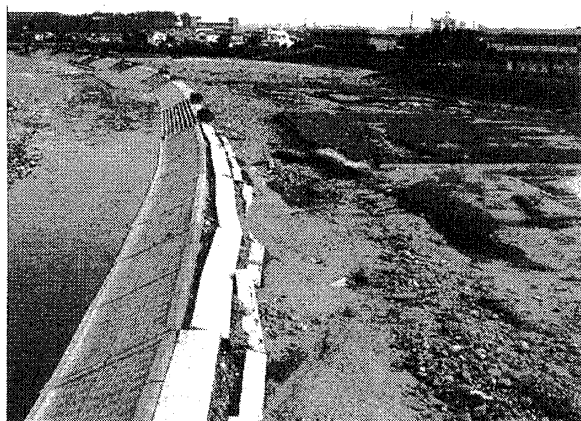
写真3 高水敷侵食例 (1998.10 三輪撮影)
