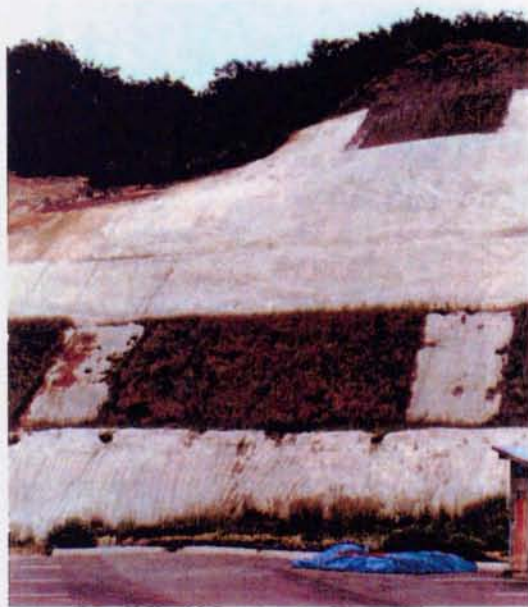
しらすの露出した法面 中央の緑茶色部分は植生試験区 (平賀町唐竹)
